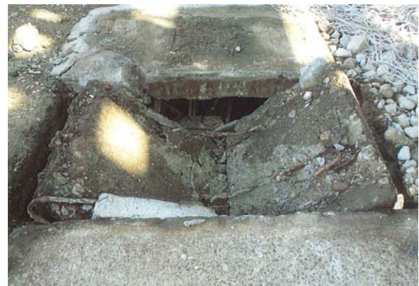
破損状況(拡大)
